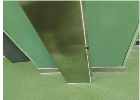
图 3-17 介入二室防护门防挤压装置
