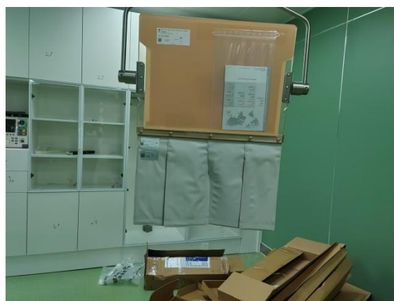
图 3-5 介入二室铅吊屏、铅吊帘
