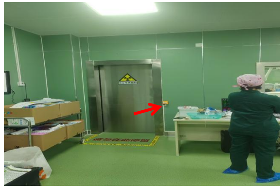
图 3-11 控制室内介入二室内 DSA 的急停按钮
