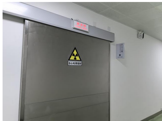
图 3-15 介入二室机房门工作状态指示灯和电离辐射标志
