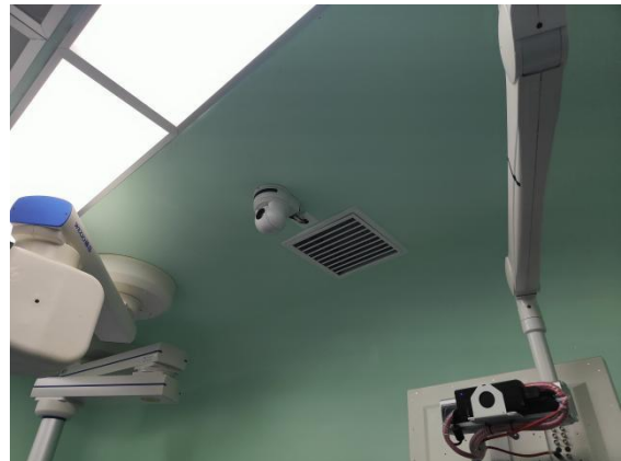
图 3-25 28 号手术室进风口、监控装置
