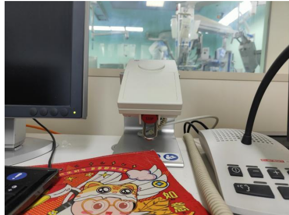
图 3-27 28 号手术间控制台紧急停机按钮
