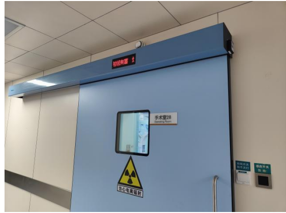
图 3-21 28 号手术室患者进出防护门工作状态指示灯、电离辐射警告标志
