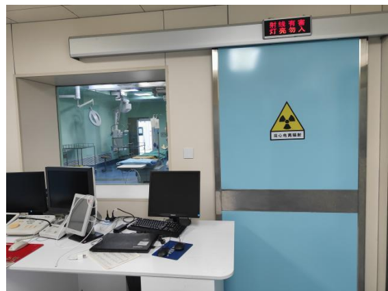
图 3-11 27 号手术室医护人员防护门、工作状态指示灯、电离辐射警告标志
