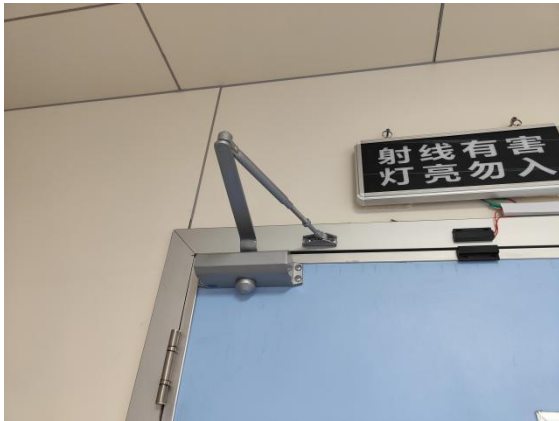
图 3-16 28 号手术间医护人员防护门自动闭门装置
