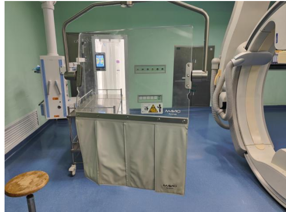
图 3-3 27 号手术间防护吊屏
