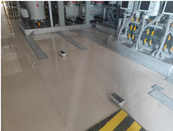
图 6-5 站内 SF 6 气体泄漏报警仪
