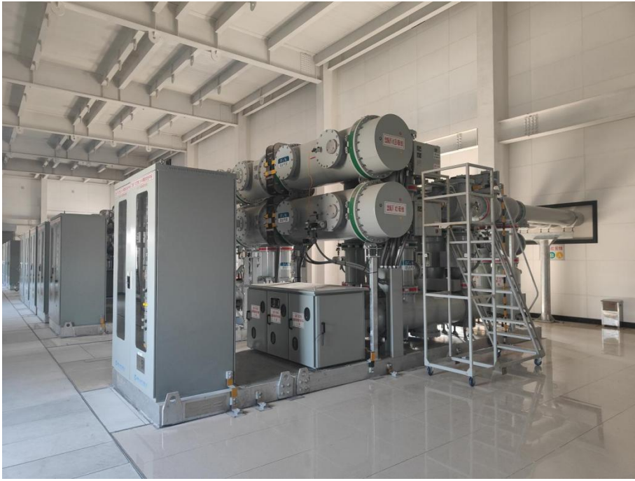
图 4-9 220 kV 配电装置
