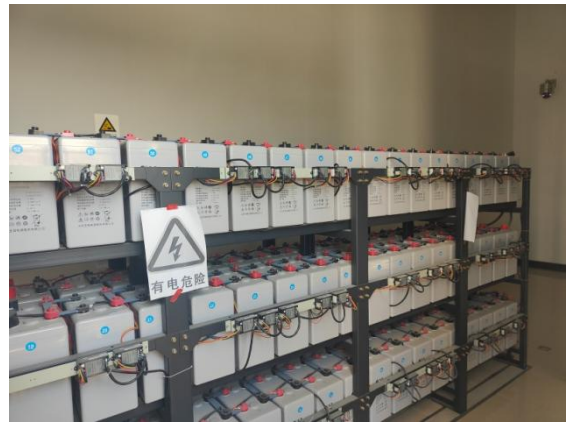
图 6-12 配电装置楼内蓄电池室
