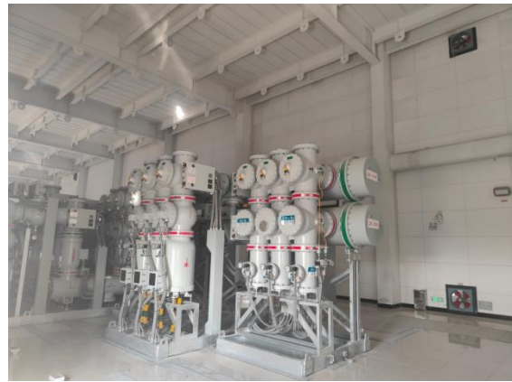
图 6-6 配电装置室内强力通风装置
