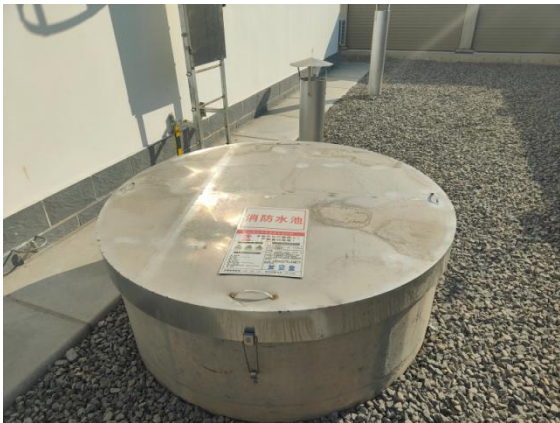
图 6-9 站内消防水池
