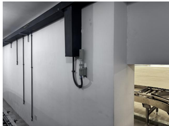
图 3-16 辐照室固定式剂量探测器
