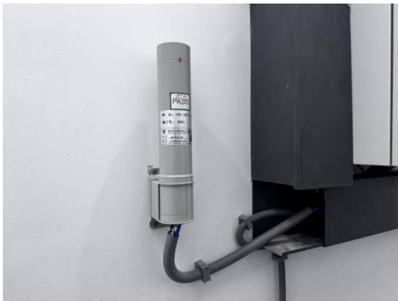
图 3-15 主机室固定式剂量探测器
