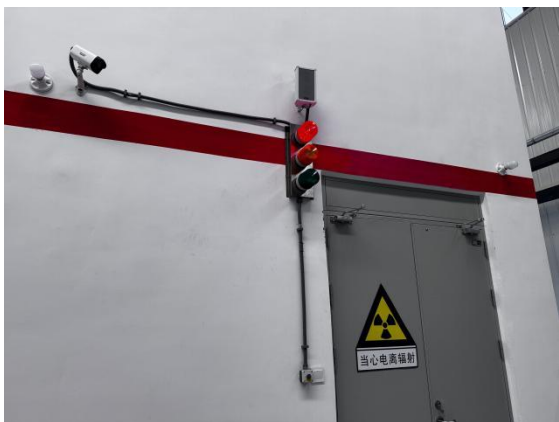
图 3-9 主机室门外电离辐射警告标志、警灯、监控探头、巡检钥匙开关
