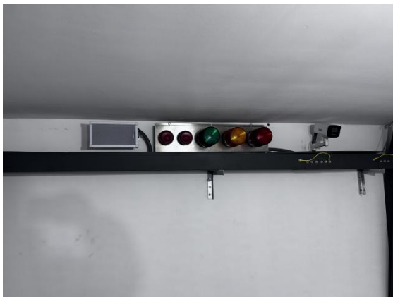
图 3-17 内部警灯、音箱、监控探头
