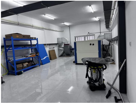
图 2-13 工具间、管通设备室
