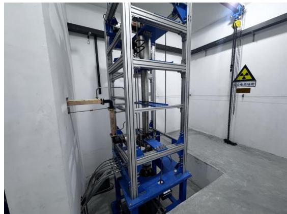
图 2-8 工业辐照加速器装置主机室内部
