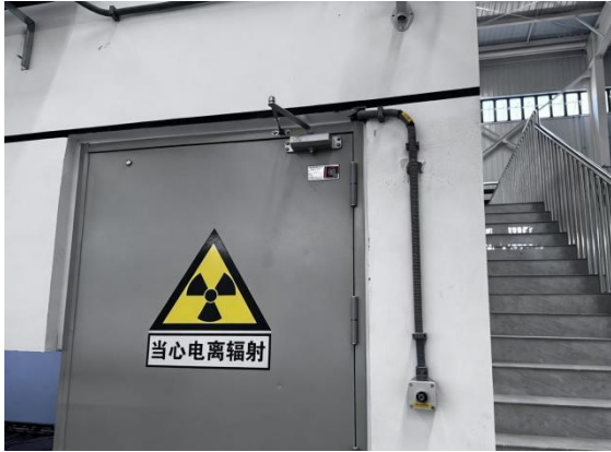
图 3-7 入货口巡检钥匙开关、电离辐射警告标志
