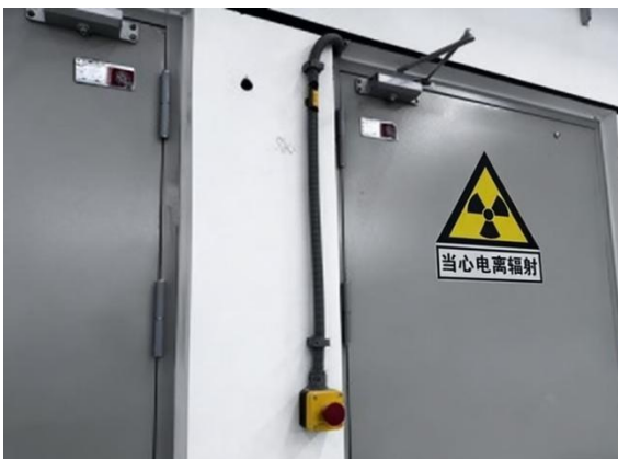
图 3-5 出货口紧急停机按钮、电离辐射警告标志
